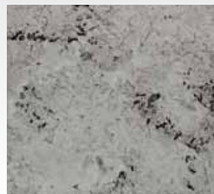
Ефект „груб бетон“
